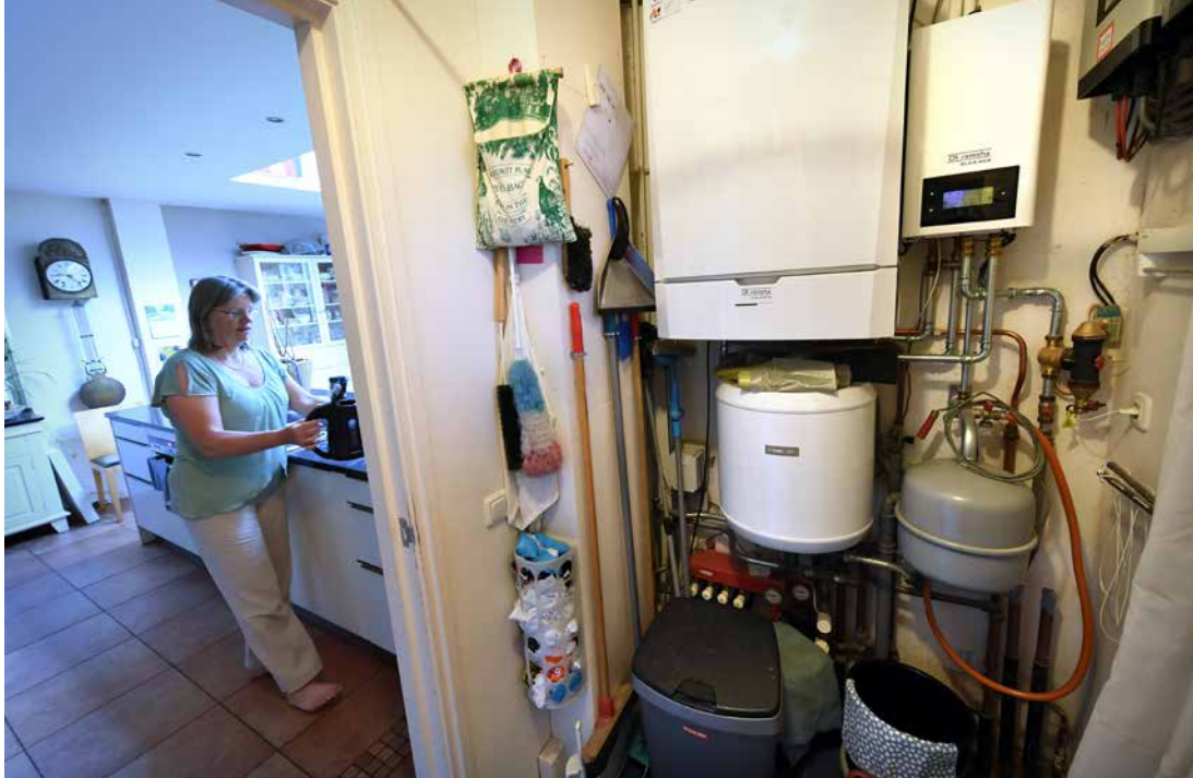
▲ Hybride warmtepomp (witte kastje naast de ketel) in woning.
