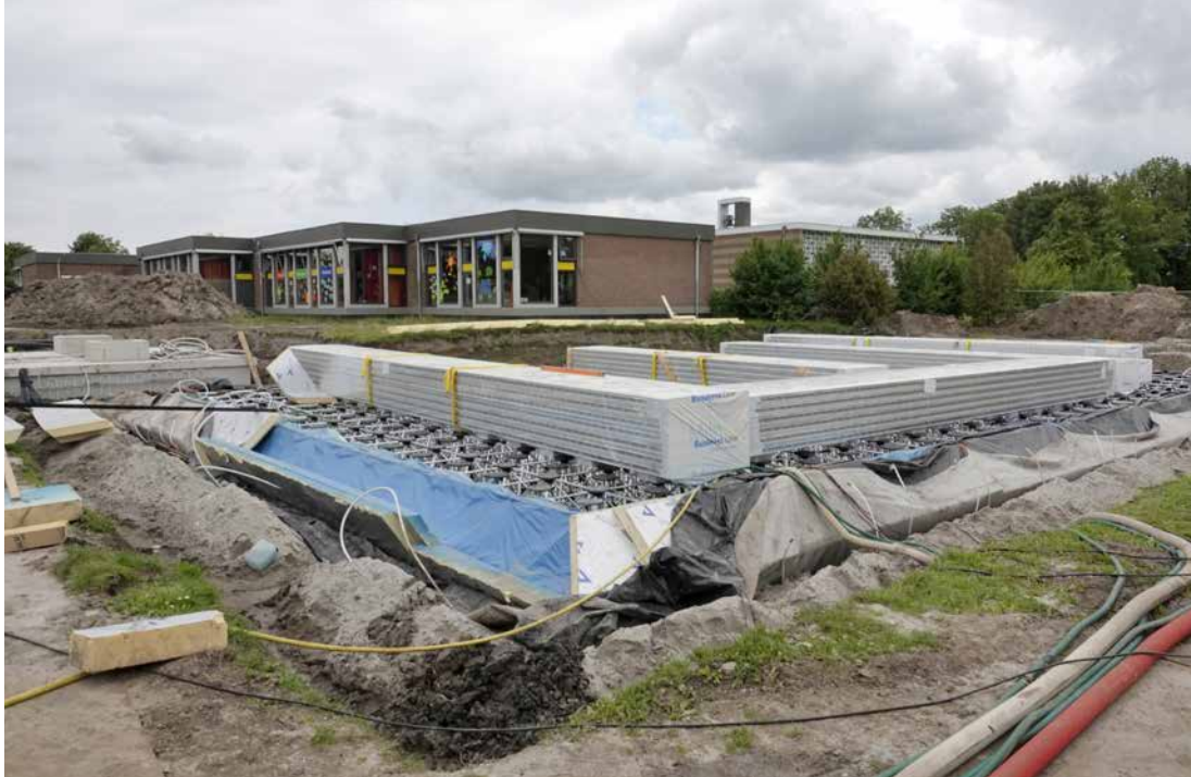
▲ In Nagele, in de Noordost-Polder, loopt een experiment waarbij warm water van zonnecollectoren in waterbassins onder de grond wordt opgeslagen voor verwarming in de winter.
